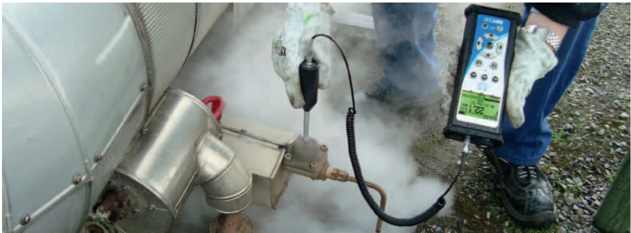
Kondensatableiterprüfung mit SDT 200
